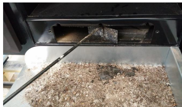
Figura nº20 - Accesos para la limpieza de la salida de humos.
